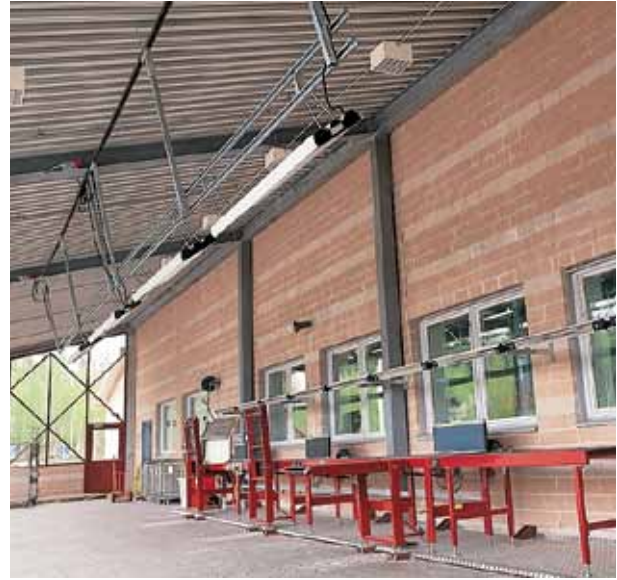
Industriinfra kan monteras vinklad för att rikta värmen dit man vill. Skall värmarna användas utomhus bör de placeras under tak. I denna installation är arbetsstationerna uppvärmda av både Industriinfra i taket och Comfortinfra CIR på väggen.
