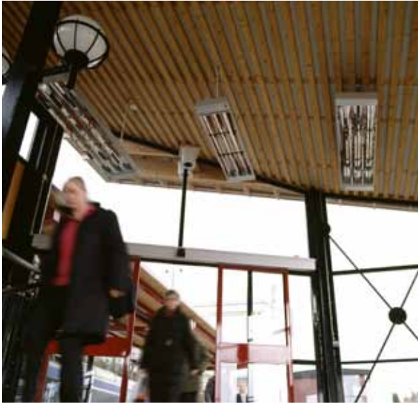
Denna tågstation utanför Stockholm värms upp med Industriinfra. En reglering med timer gör att väntande passagerare själva kan höja temperaturen när det är mycket kallt.
